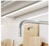
Bänkbelysning: Bänkbelysning LED-list under väggsåp i kök, inklusive dekorlist
